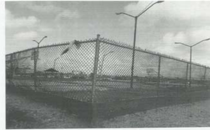
Sobre calle licenciados esquina con calle técnicos enredada y atada a la malla ciclónica de la plaza en cita, una lona desgastada.
