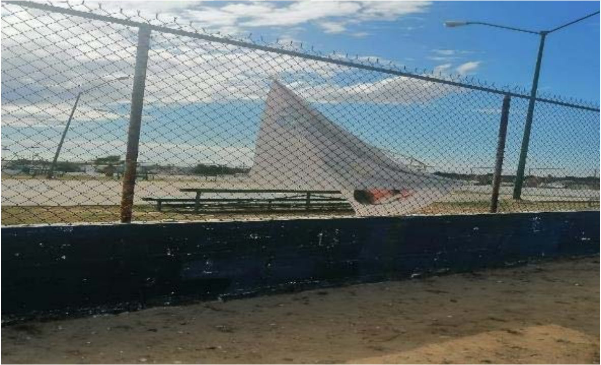
Una lona (No. 3), por la calle técnicos, dicha lona se encuentra doblada
